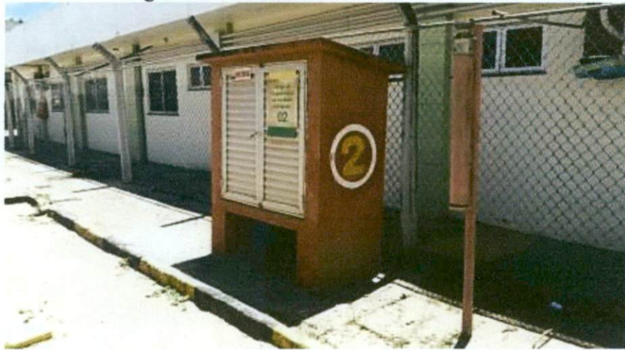
Figura 22 – Sistema de Combate a Incêndio.
