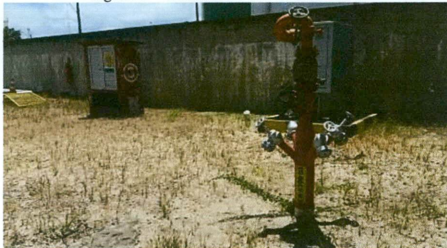
Figura 23 – Sistema de Combate a Incêndio.
