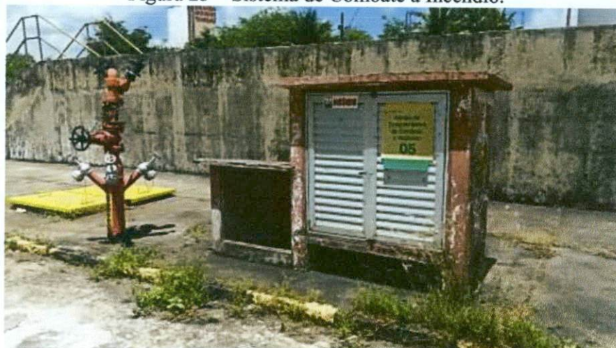
Figura 25 – Sistema de Combate a Incêndio.
