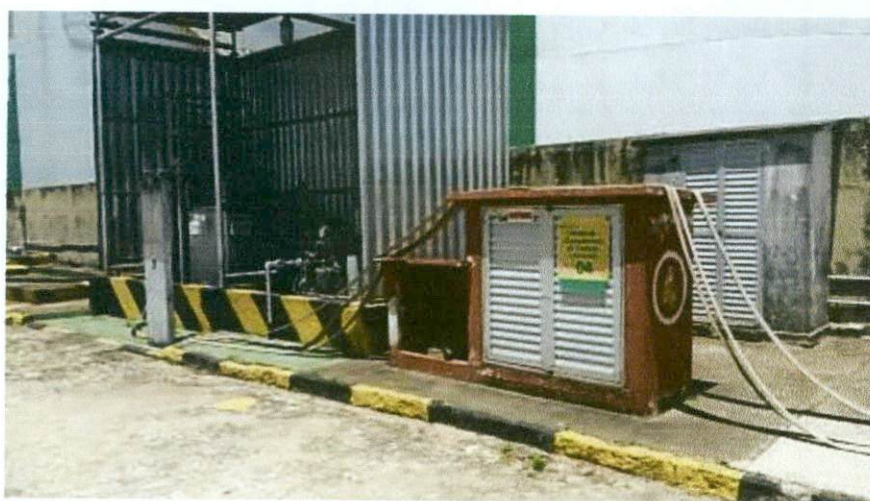
Figura 24 – Sistema de Combate a Incêndio.
