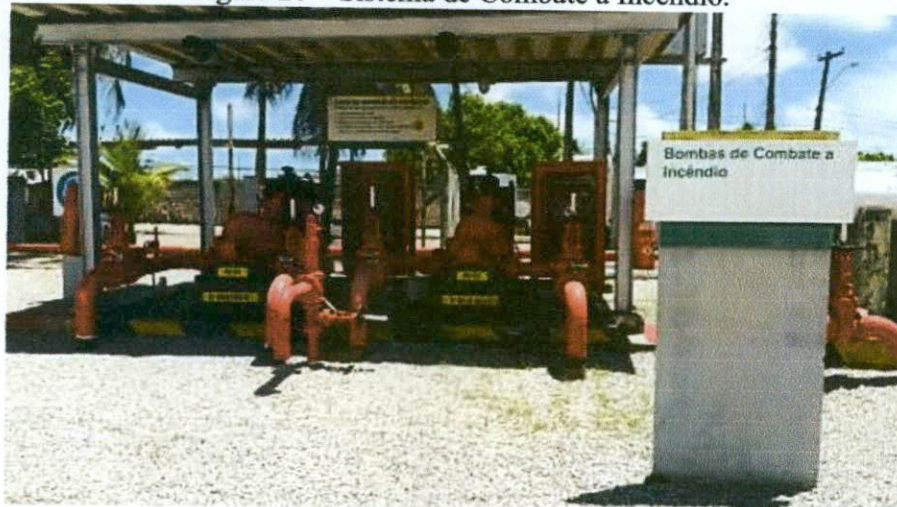
Figura 20 – Sistema de Combate a Incêndio.
