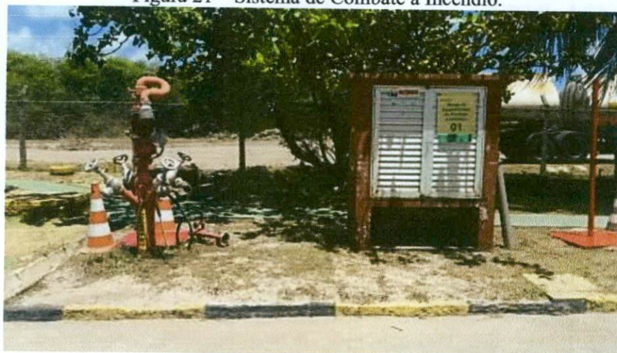
Figura 21 – Sistema de Combate a Incêndio.
