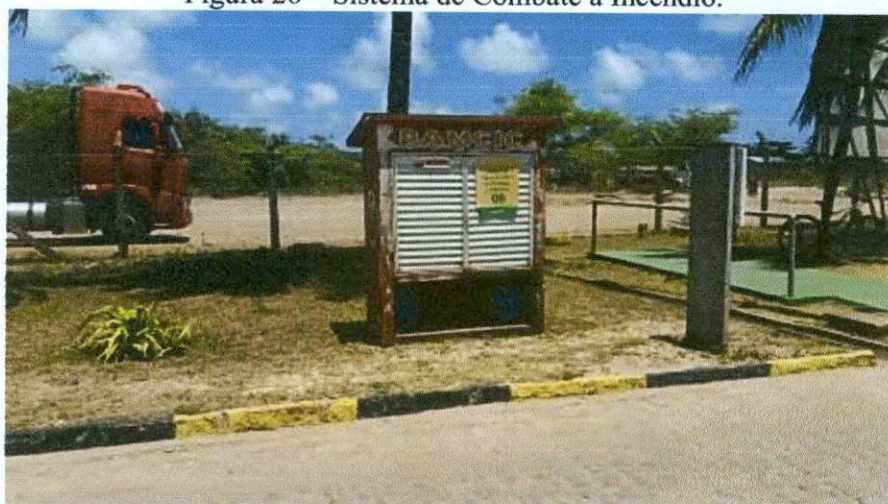
Figura 26 – Sistema de Combate a Incêndio.
