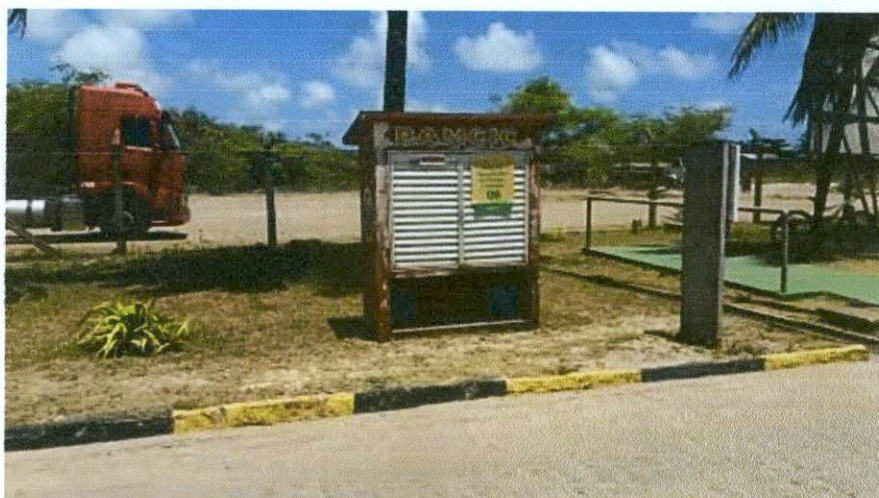
Figura 27 – Sistema de Combate a Incêndio.
