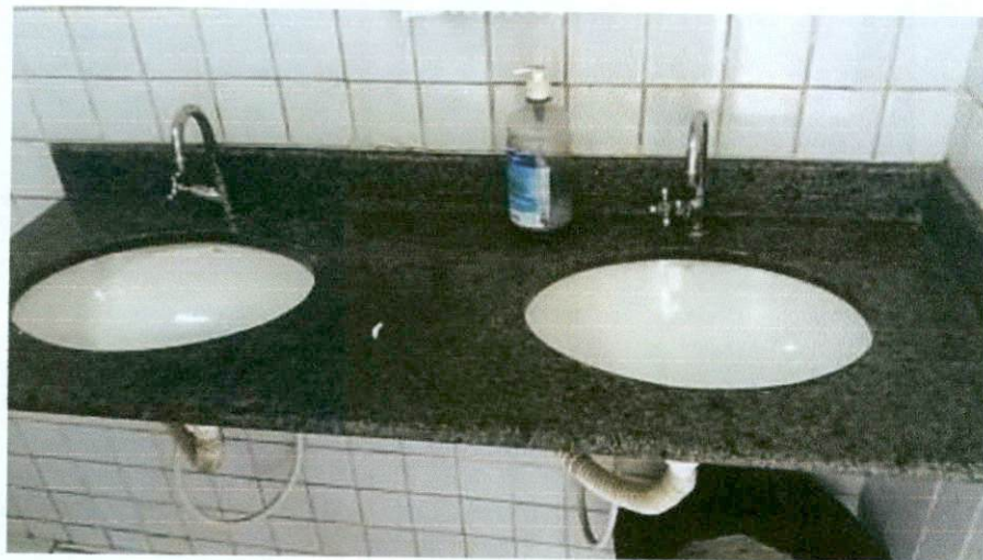
Figura 16 – Água e Esgoto.
