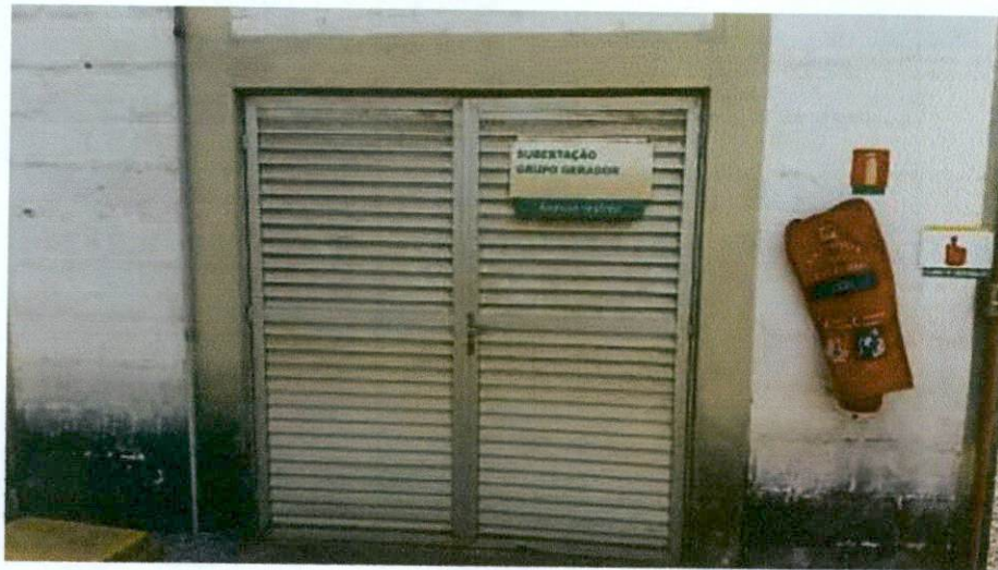
Figura 12 – Distribuição Elétrica e Iluminação.
