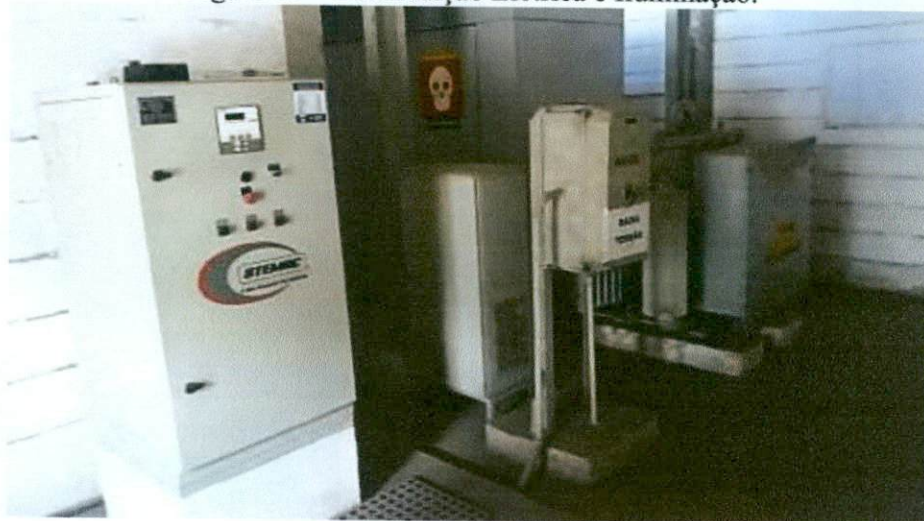
Figura 13 – Distribuição Elétrica e Iluminação.
