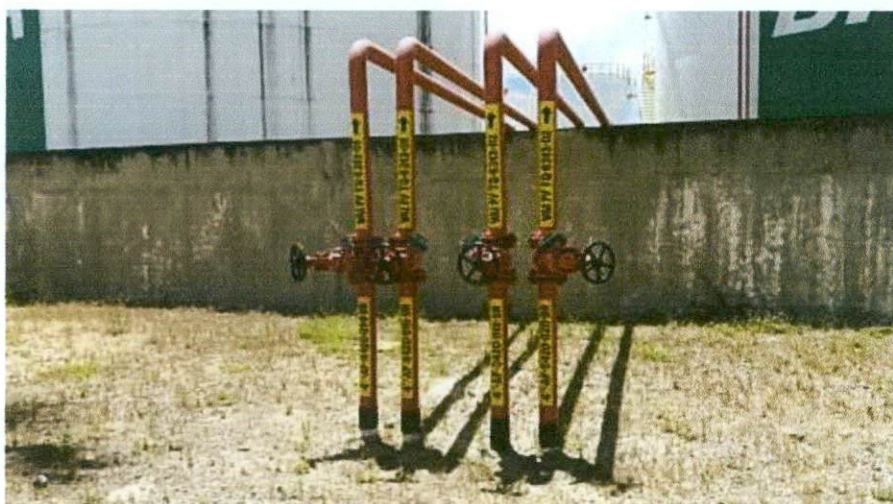
Figura 30 – Sistema de Combate a Incêndio.
