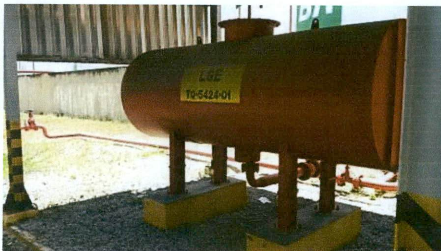
Figura 29 – Sistema de Combate a Incêndio.
